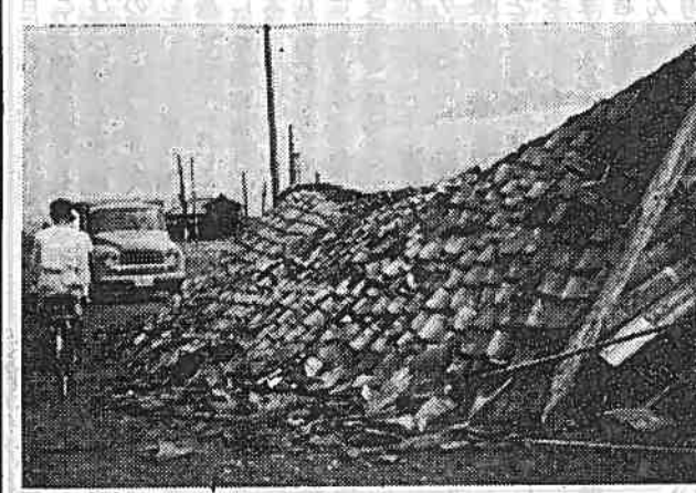
屋根瓦が崩れ道路も通行止め (新田助六)
