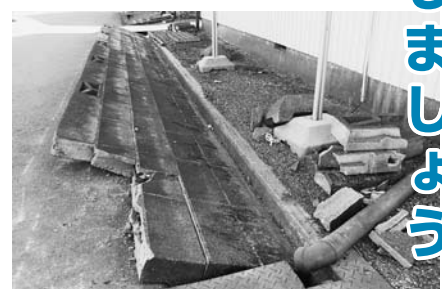
静岡県東部地震によるブロック塀の倒壊(市内)
