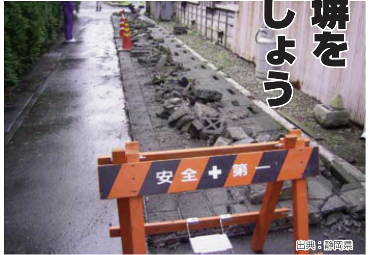
▲駿河湾を震源とする地震（平成21年8月11日）によるブロック塀の倒壊
