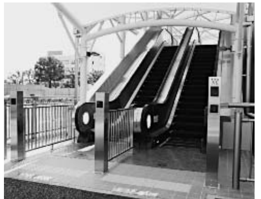
新設された市庁舎東側エスカレーター
