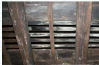
換気用の格子状の天井板
