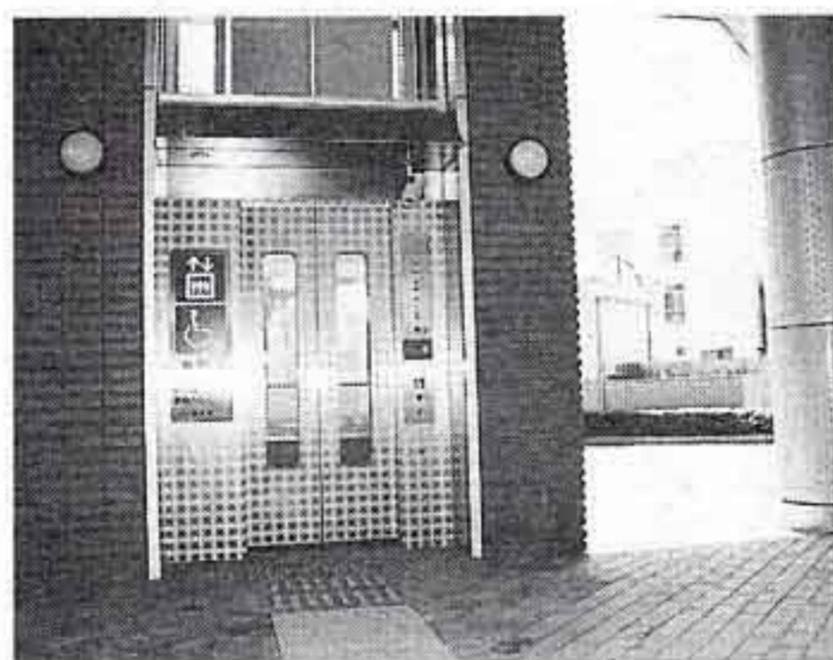
▲富士駅南口エレベーター
