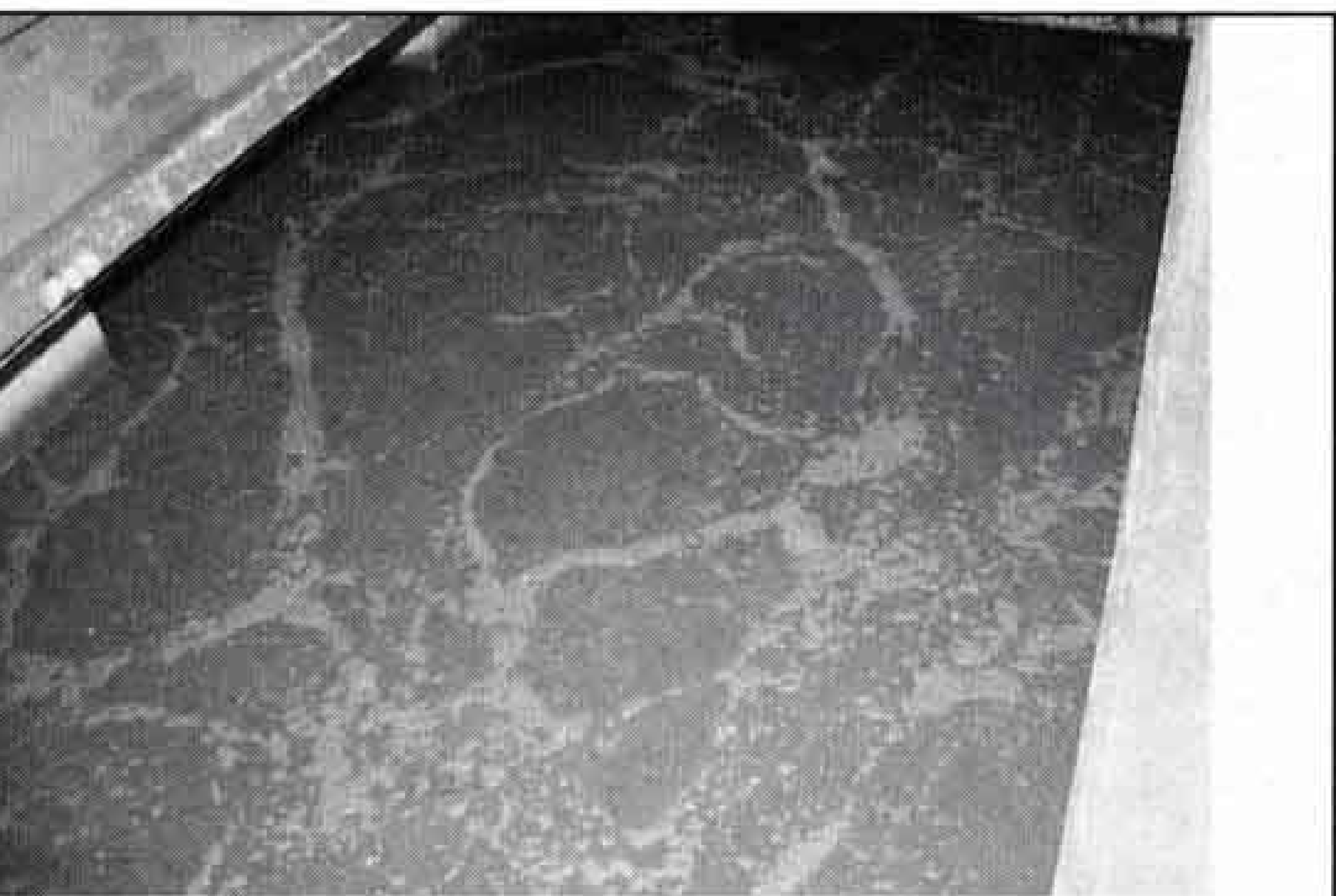
△微生物が汚れを食べるエアレーションタンク
