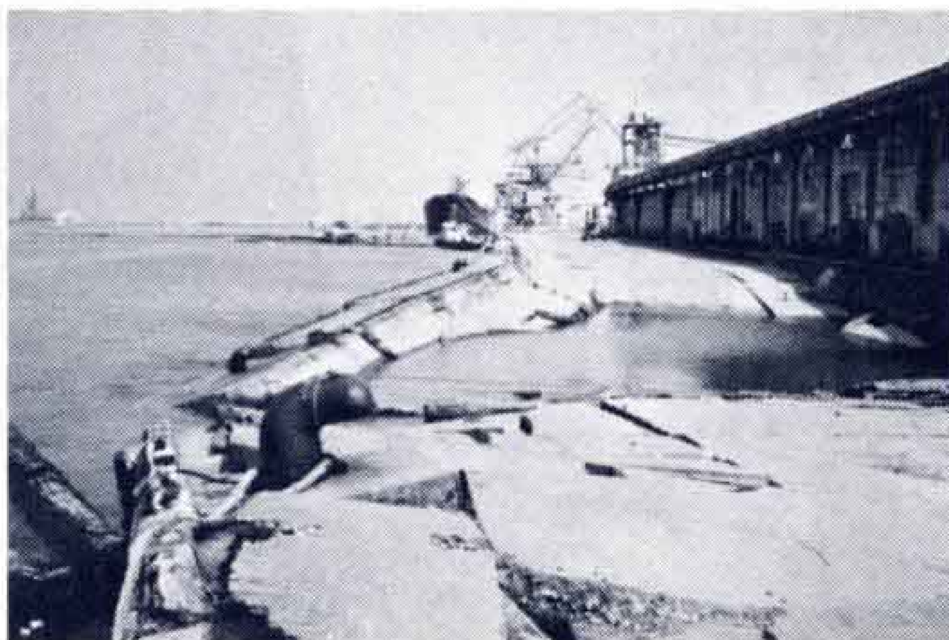
「日本海中部地震」の津波による被害
