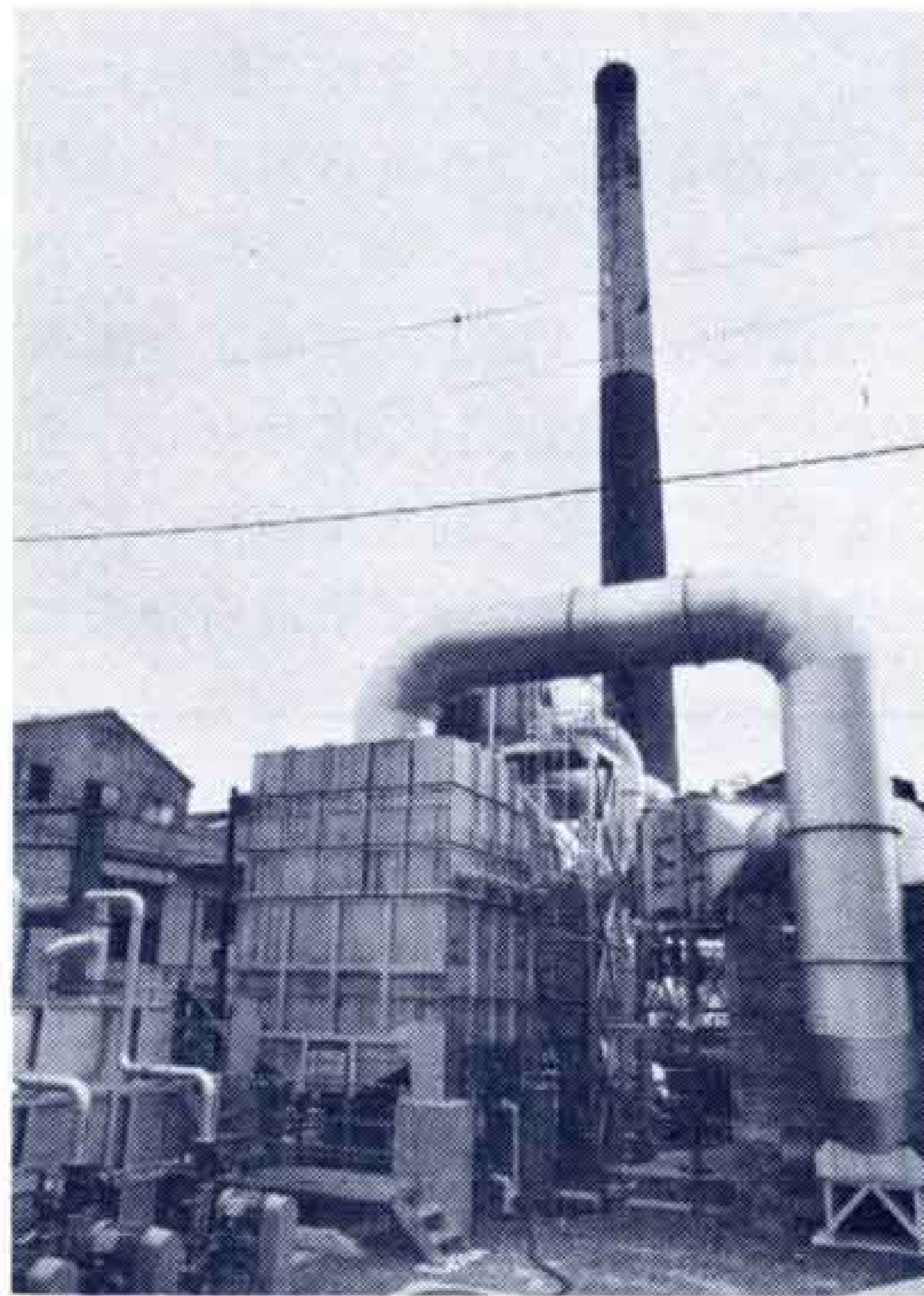
【K工場の排煙脱硫装置】
