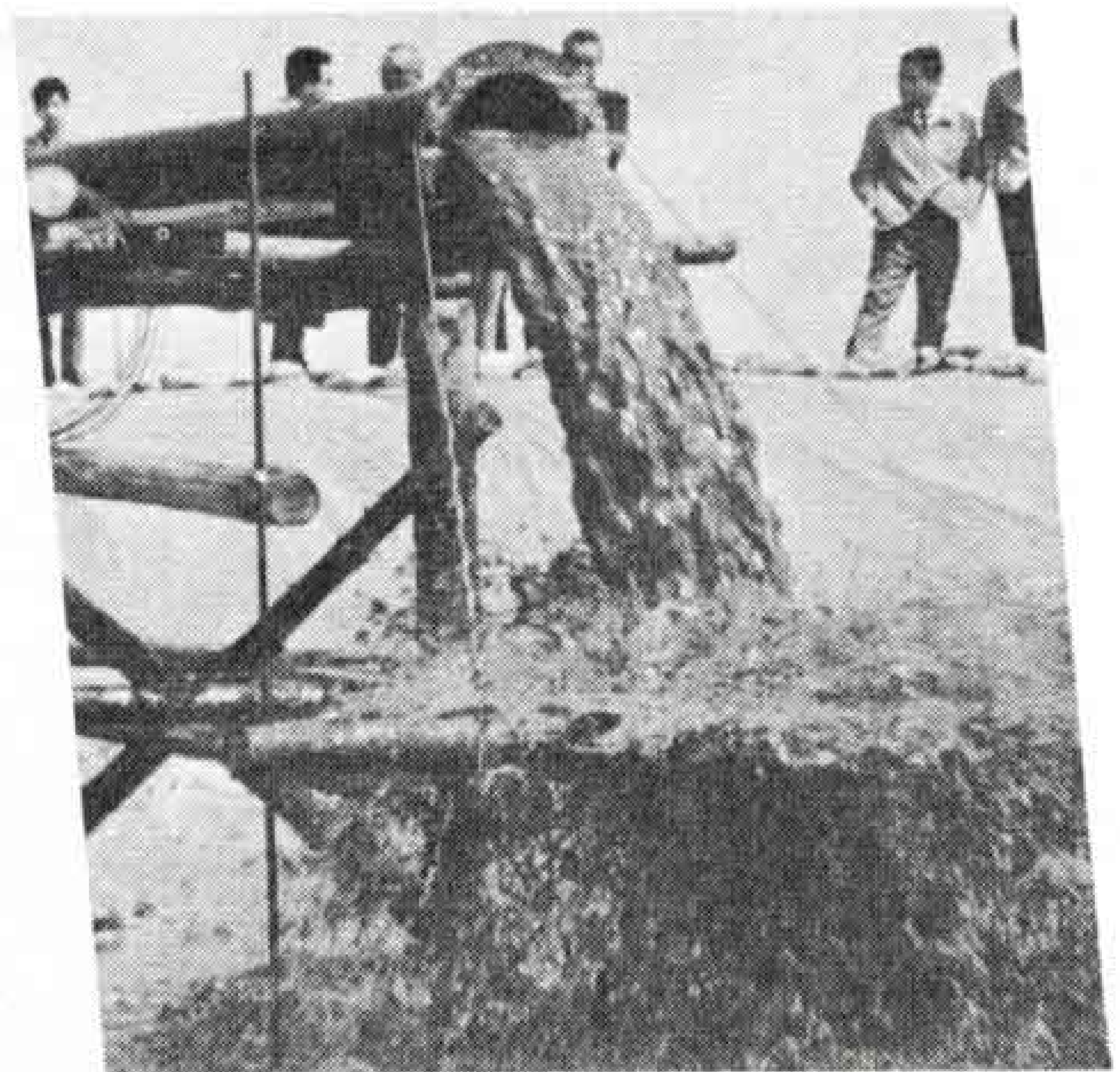
富士川河口敷8万平方mに、砂利を積みあげて処理場をつくりここでへドロを脱水
