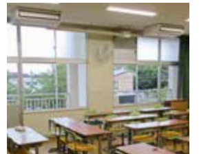
富士中学校の普通教室に設置されたエアコン
