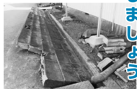
静岡県東部地震によるブロック塀の倒壊(市内)
