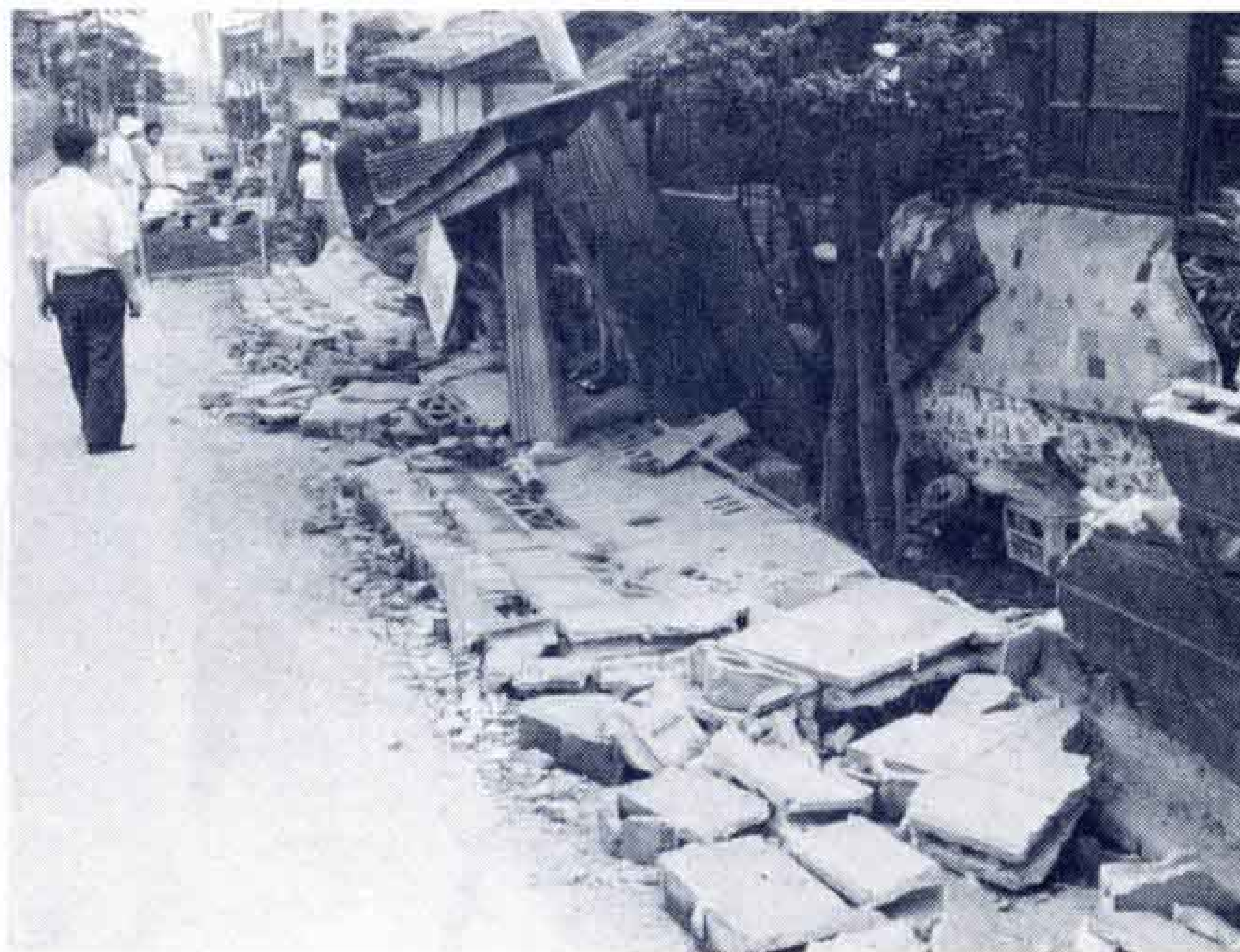
バツタリ倒れたブロックべい
