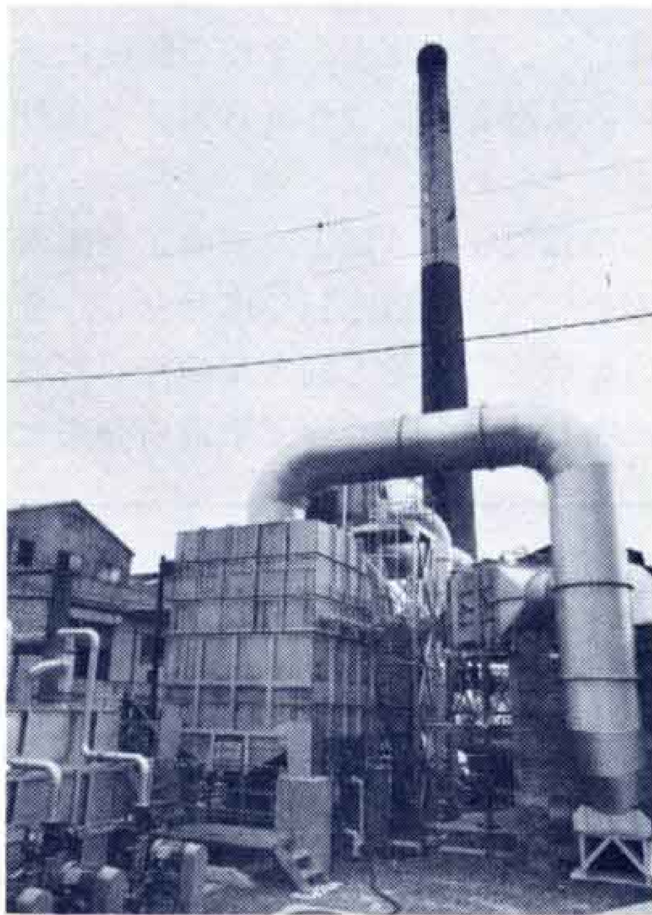
【K工場の排煙脱硫装置】
