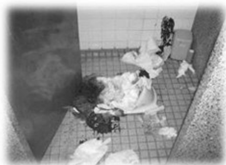
断水により汚れたトイレ
