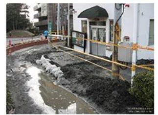
▲ 地盤沈下により傾いた交番
