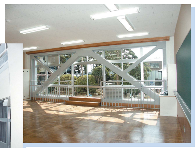
▲ブレースが設置された教室
