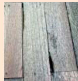
▼⑧教室床材の剥離
