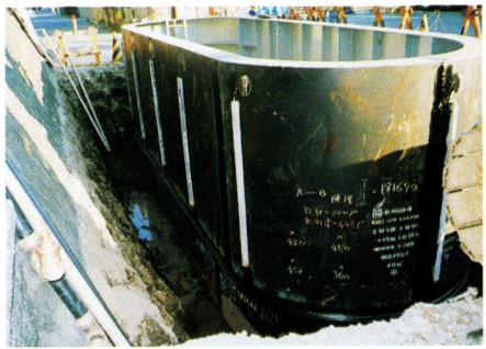
新町本町区に設置しました耐震性防火水槽です
