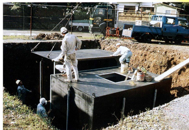
安全なまちづくりのため、耐震防火水槽の設置が行われます。
