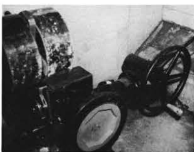
設置された緊急しゃ断弁
