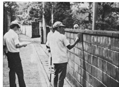
横筋なし／ ひび割れあり／
