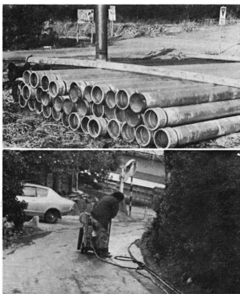
新しく掘られた上水道深井戸 送配水管布設によるコンクリートカッター
