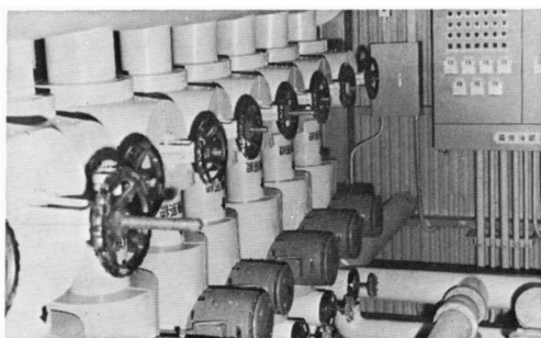
空気調節設備の一部
